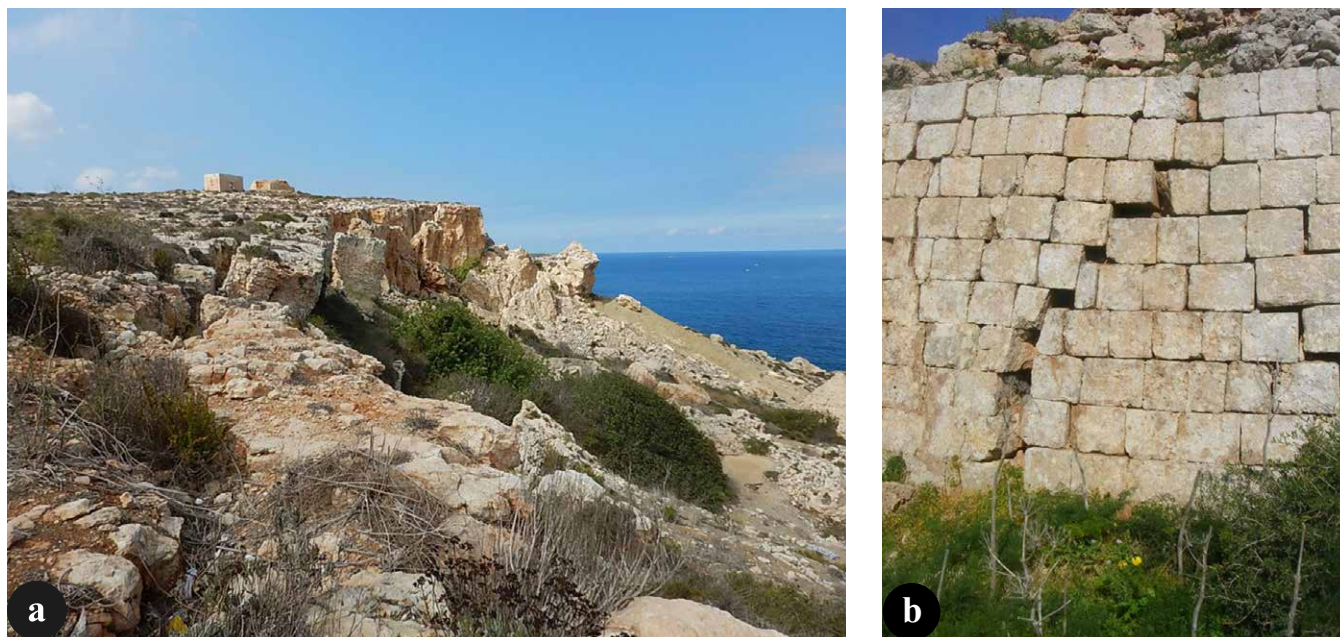
Fig. 4 - L'espandimento laterale del promontorio di Selmun (Malta): a ) vista del versante costiero instabile per frana con le torri di guardia di Ghajn Hadid oggi minacciate dall'arretramento della scarpata di frana; b ) evidenza di danni alle murature delle torri di guardia per effetto delle fratture beanti che si sono formate a monte del ciglio della scarpata in frana.
